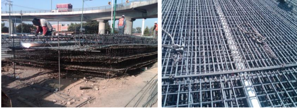
Figura 55. Colocación de tubería de PVC de 6" en armado de parrilla. Fuente: Cortesía del proyecto Marina 385
