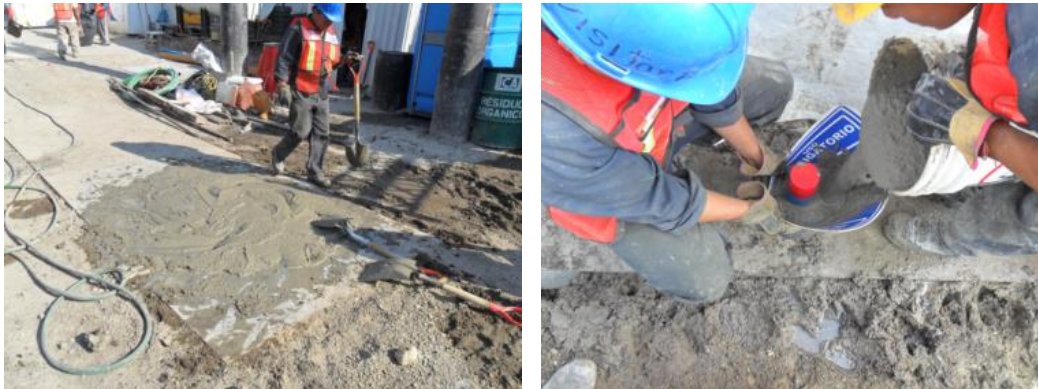
Figura 60. Elaboración de lechada en obra y colocación de lechada en espacio anular. Fuente: Cortesía del proyecto Marina 385
