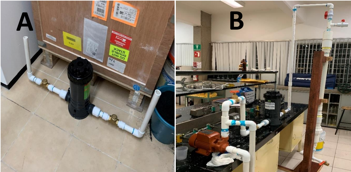
Figura 7.8. Dosificador FibroPool® FC 200 adaptado con válvulas, reducciones y tubo de PVC 1" (A). Sistema de bombeo, desinfección y filtración instalado en el laboratorio (B). Fuente: Directa (2019)
