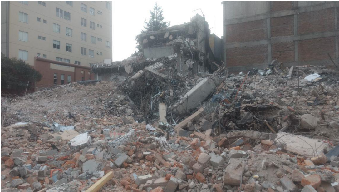
Fig. 7.3 Residuos de la demolición por sismo en la calle Puebla 77, alcaldía Cuauhtémoc.
