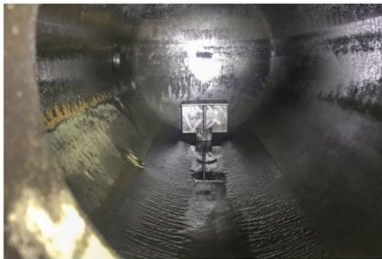
(b) Después de una operación de limpieza, se eliminó toda la arena; se observa que las marcas en las paredes del separador indican el nivel típico de la producción de los líquidos asociados.
