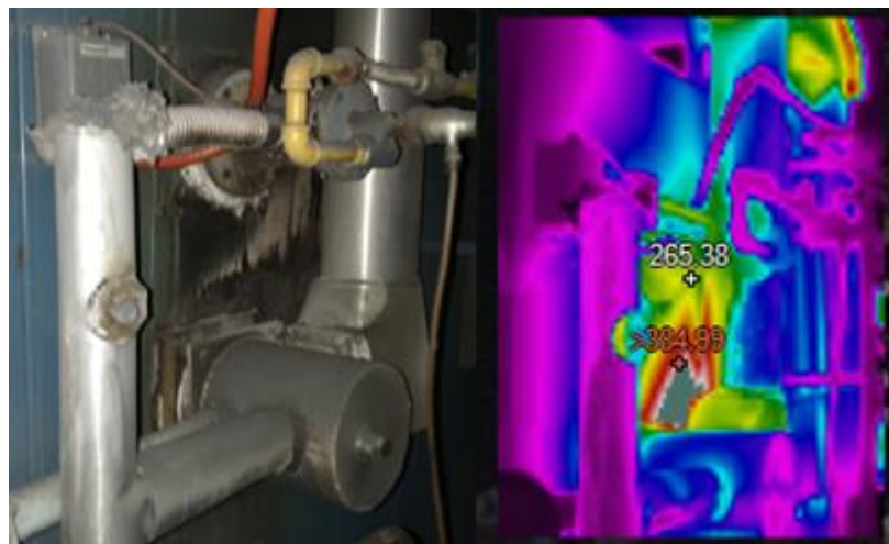
Imagen 2. 1 Región de degradación y termografía de la zona afectada
