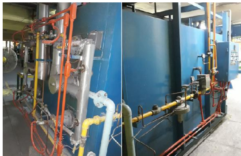
Imagen 2. 2 Instalaciones en parte posterior y lateral
