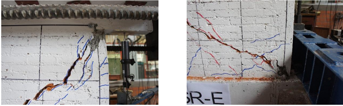
Grietas diagonales en extremos de castillos
