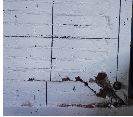
Grieta diagonal en castillo (parte inferior)
