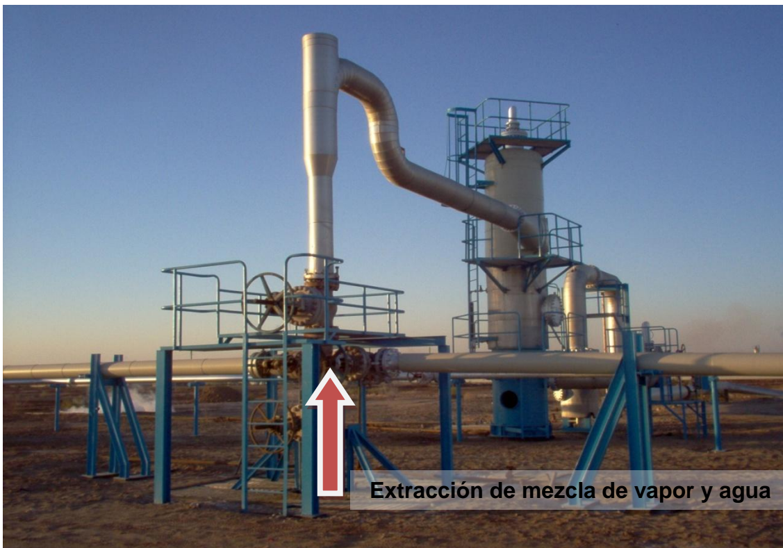
Figura 3. Pozo geotérmico Cerro Prieto, B.C. (Extracción de mezcla de vapor y agua proveniente de yacimiento geotérmico a profundidades mayores a 2000 metros)
