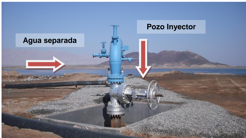
Figura 3.5 Pozo Inyector de Salmuera Separada, Campo Geotérmico de Cerro Prieto, B.C.
