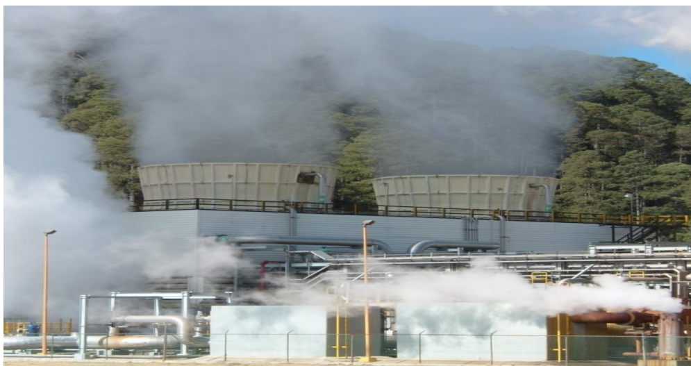
Figura 3.3 Torre de Enfriamiento. Los Azufres, Morelia
