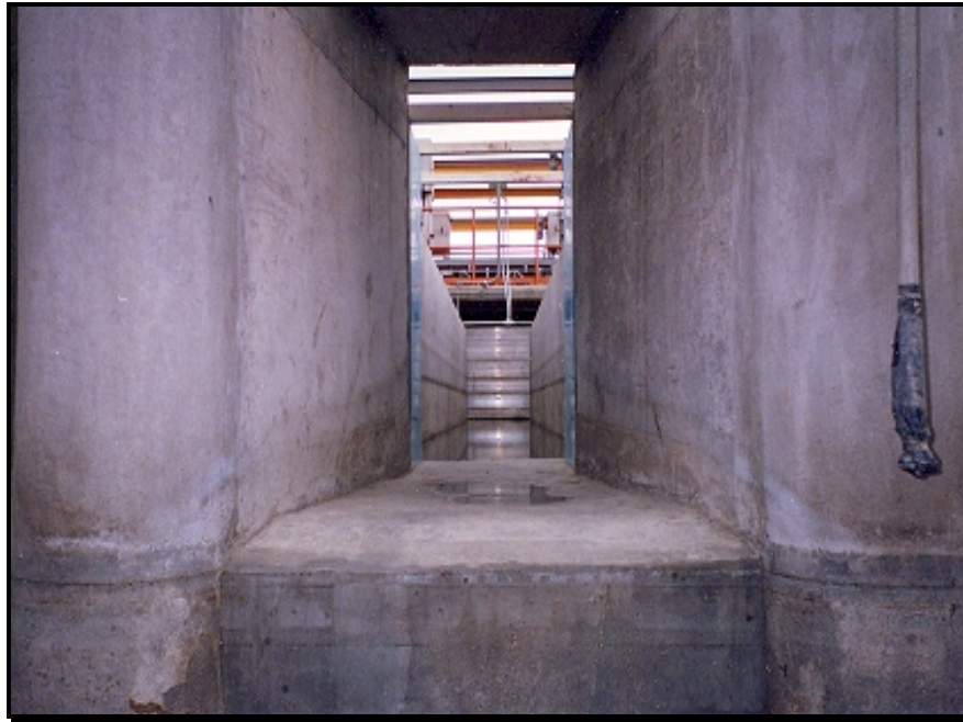
Figura V.24. Área de la sección transversal de uno de los tres canales venturís para la medición del gasto influente en la Planta Norte. Obsérvese al lado derecho el electrodo para la medición del parámetro potencial de hidrógeno
