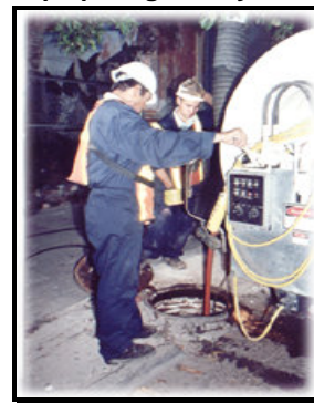
Figura V.6. Desazolve de un pozo de vista mediante un camión tipo "vector", debido a obstrucción por presencia de grasas y aceites
