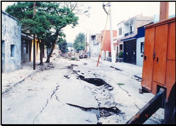
Calles colapsada, por la explosión en la red de drenaje, en una zona de la Ciudad de Guadalajara (SIAPA, 1999)
