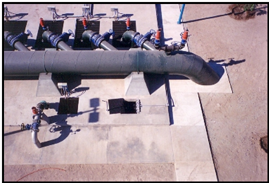
Figura V.20. Tanque de la estación de bombeo Rubí, obsérvese el cabezal de descarga y las válvulas de admisión y expulsión de aire
