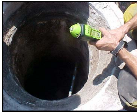
Figura IV.1. Seguimiento monitorio del nivel de explosividad, como LEL (lower explosivity level), en un pozo de visita de la red de alcantarillado
