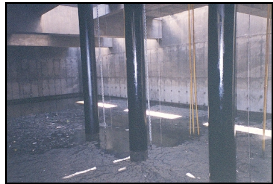
Figura V.21. Tubería de descarga de las bombas sumergibles ubicadas en el tanque de la estación de bombeo Rubí
