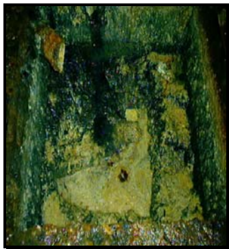
Figura V.5. Trampa para grasas y aceites de un establecimiento de comida rápida, azolvada por falta de limpieza
