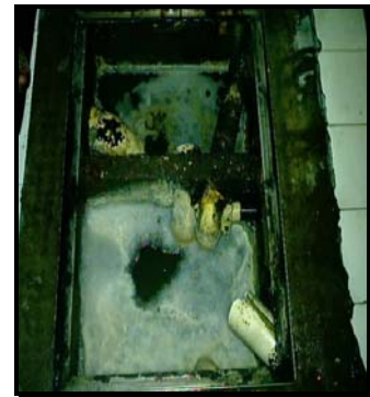
Figura V.4. Interior de una trampa para grasas y aceites
