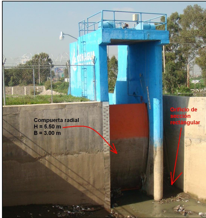
Fig 1.11.- Compuerta radial de la derivadora San Francisco
