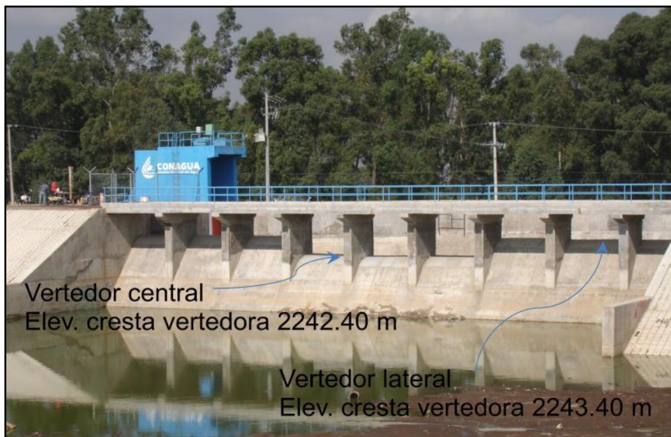
Fig 1.12.- Vertedor lateral de la derivadora San Francisco
