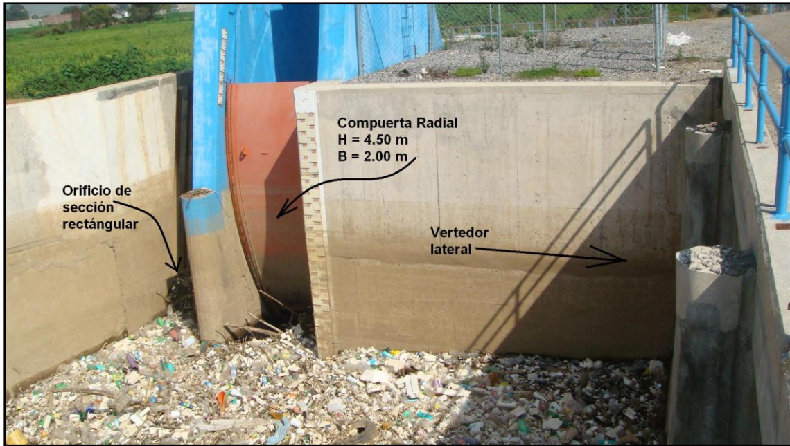
Fig 1.5.- Compuerta radial de la derivadora San Rafael.
