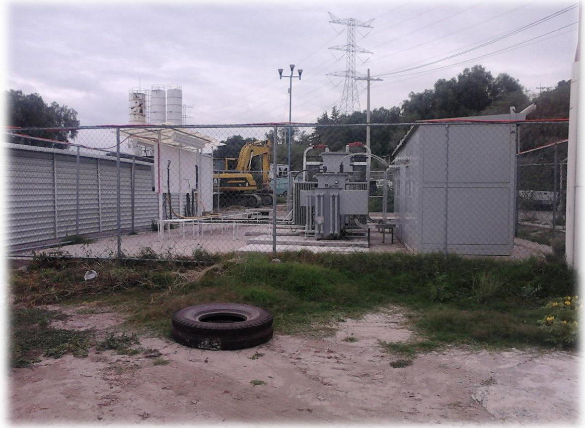
3.5.2 Instalaciones de Subestación Eléctrica en Portal de Salida
