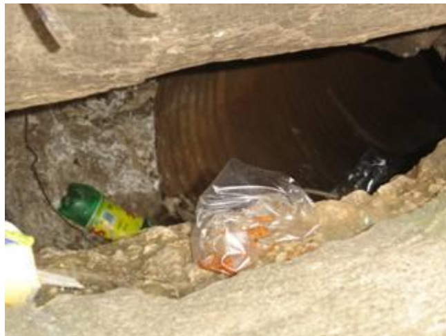
Entrada de un registro hacia el colector del drenaje.
