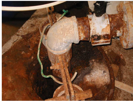
Estado físico del tren de descarga que presentaba el pozo de Janitzio
