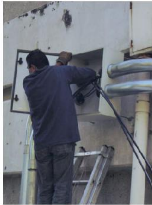
Figura 1.10 Acometida a Instalaciones STC
