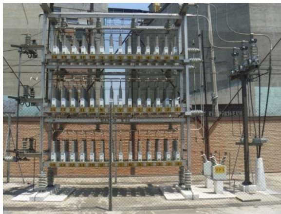
Figura C-12 Banco de capacitores en 23 kV
