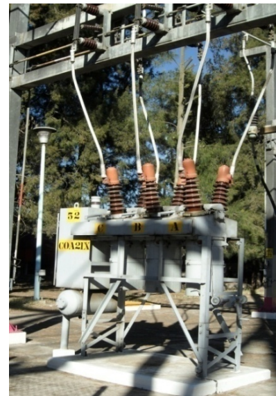
Figura C-4 Interruptor en vacío
