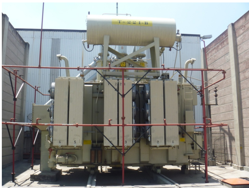
Figura C-1 Transformador T221B en Subestación Peralvillo
