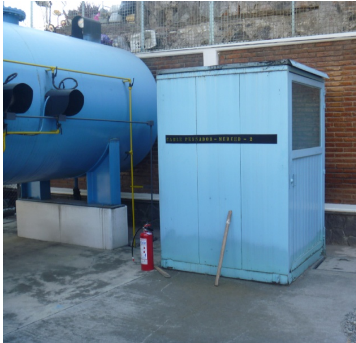
Figura 2-4 Tanque de aceite y caseta de control del cable Merced-2
