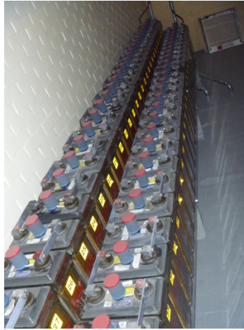
Figura C-14 Banco de baterías
