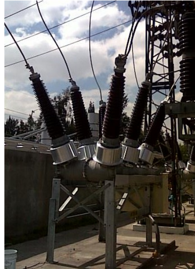
Figura C-3 Interruptor SF 6 tanque muerto
