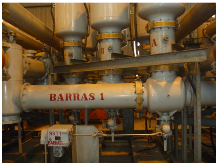
Figura 3-4 Estando de las cuchillas 93 T1 en la subestación Peralvillo
