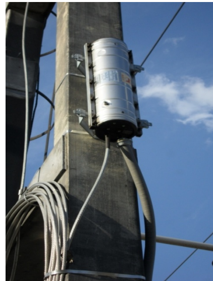
Figura C-16 Caja de acoplamiento de fibra óptica a la llegada de una subestación
