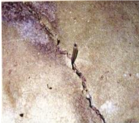
Fig. 5.19 Las grietas mayores que 3 mm de ancho son candidatas para colocarles puertos de inserción (Trout, 2005)
