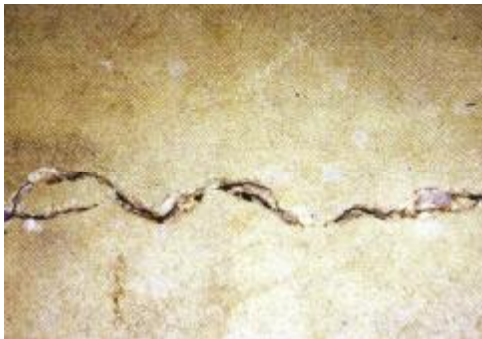
Fig. 5.6 La limpieza y anchura de esta grieta (> 2.2 mm) la hacen idónea para relleno (Trout, 2005)
