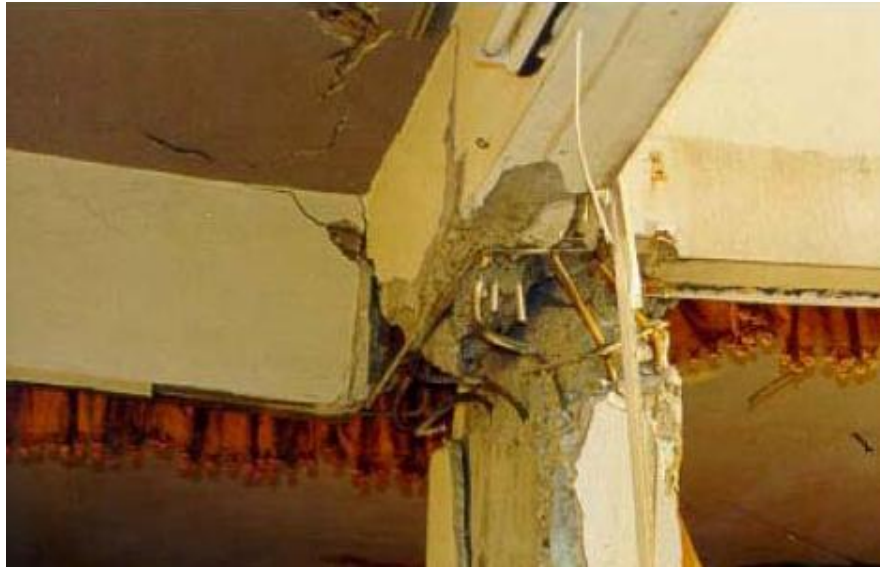
Fig. 2.9 Falla en uniones (Thermou y Elnashai, 2002)
