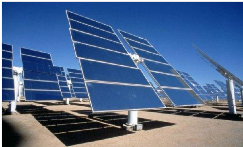
Figura 2.15: Campo de celdas fotovoltaicas.
