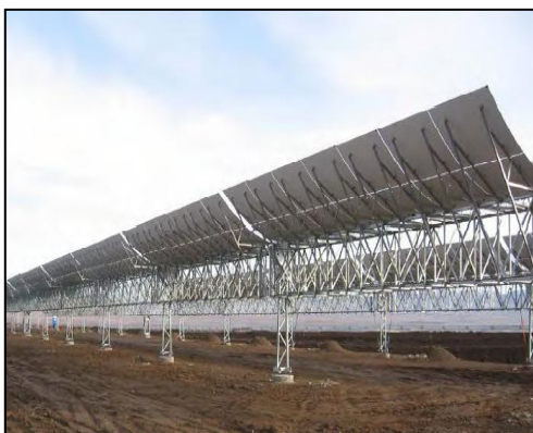
Figura 4.10: Filas de colectores en la planta Andasol-1.
