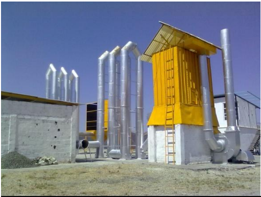
Imagen 4. Ductos de enfriamiento, casa de sacos y extractor.
