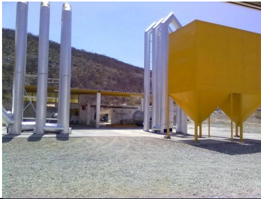
Imagen 5. Instalaciones de la planta de beneficio.
