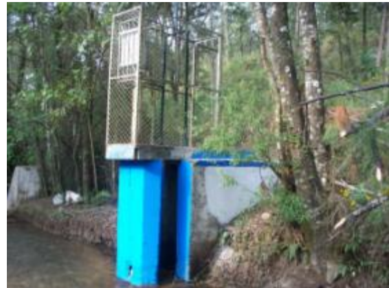
Estación hidrométrica automática
