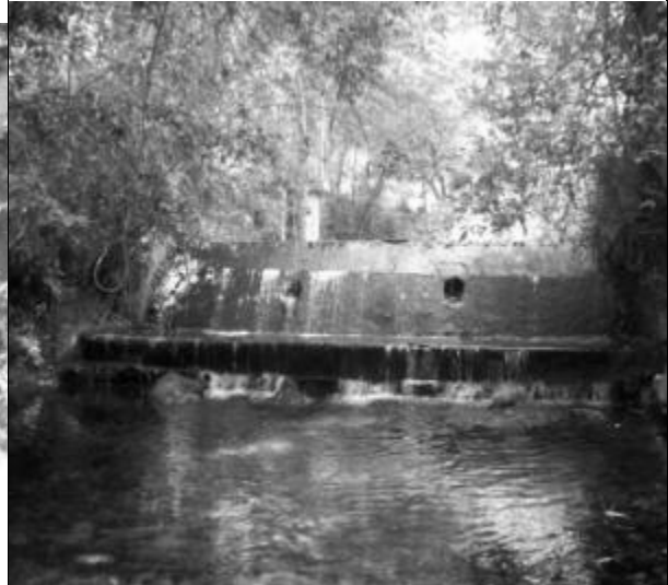
Vista del vertedor con azolve y maleza
