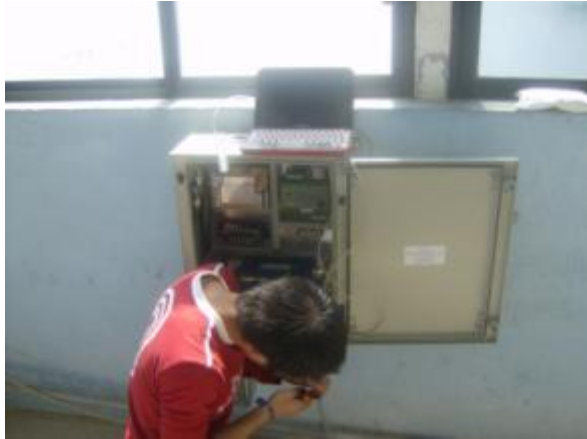
Conexiones de los equipos en gabinete
