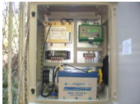
Elementos en gabinete de la estación hidrométrica
