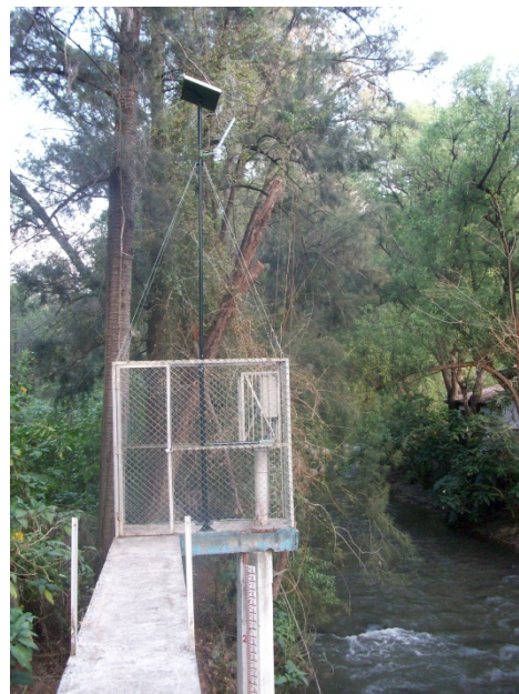
Estación Hidrométrica Automática
