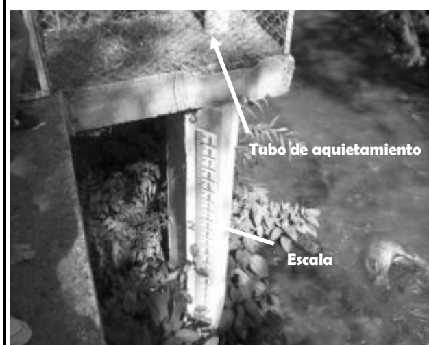
Detalle de la escala y tubo de aquietamiento con azolve
