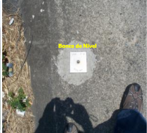
Banco de nivel en la cortina de la presa
