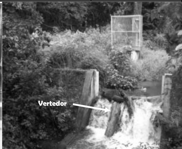
Detalle de azolve en el vertedor
