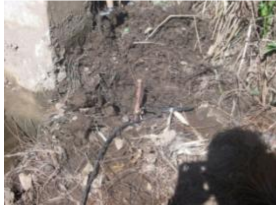
Sistema de puesta a tierra
