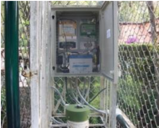
Estación Hidrométrica Automática
