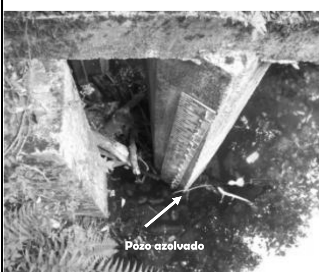
Detalle del pozo de aquietamiento azolvado
