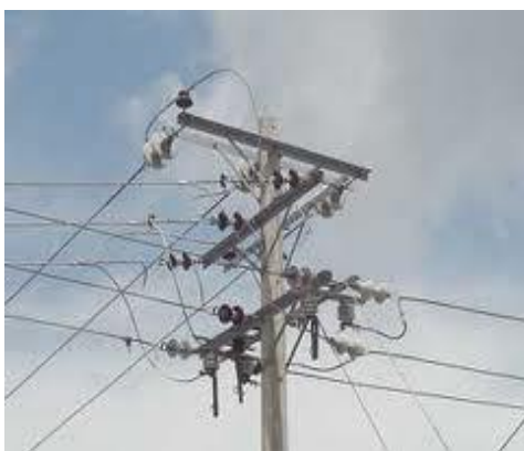
Figura F.3.- Conductores a la intemperie
