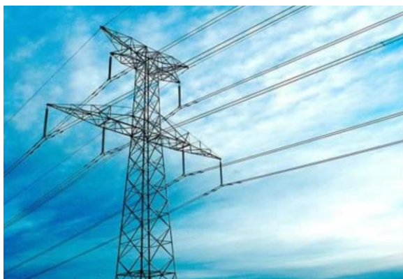
Figura F.1.- Red eléctrica aérea
