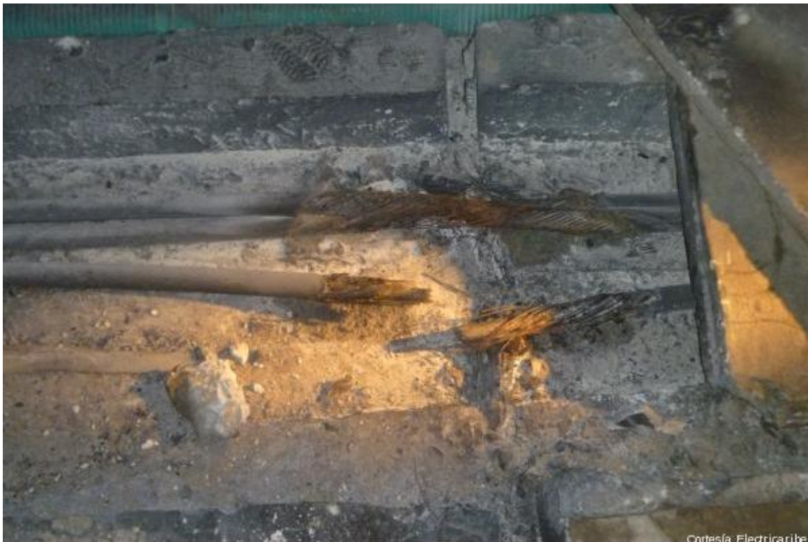
Figura A.1.- Falla trifásica debida al intento de robo de cables en un sistema de media tensión.
