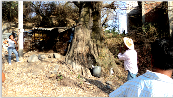
Reporte fotográfico inicial para el trazo de la apertura de la calle
