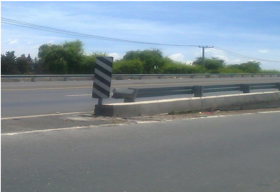
Fig. I.5.10. Defensas metálicas galvanizadas.
