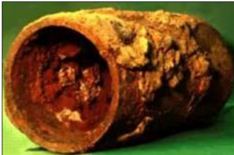
Fig B.3. Tubo con Problemas de Corrosión
