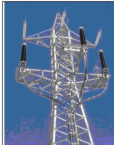
Figura 2.11 Torre de transición
