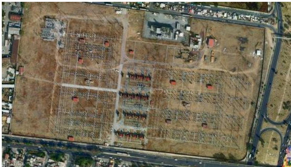
Figura 2.8 Vista aérea de la subestación Santa Cruz.
