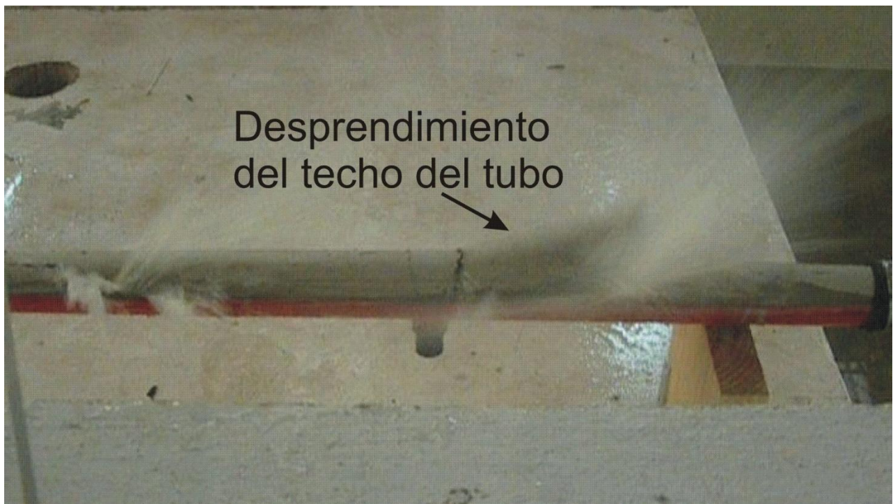
Figura 5.26 Desprendimiento de un fragmento del techo de la tubería, seguido de una importante fuga de agua
