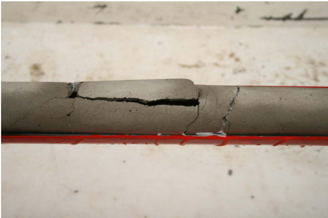
Figura 5.22 Ruptura y levantamiento de la clave del tubo
