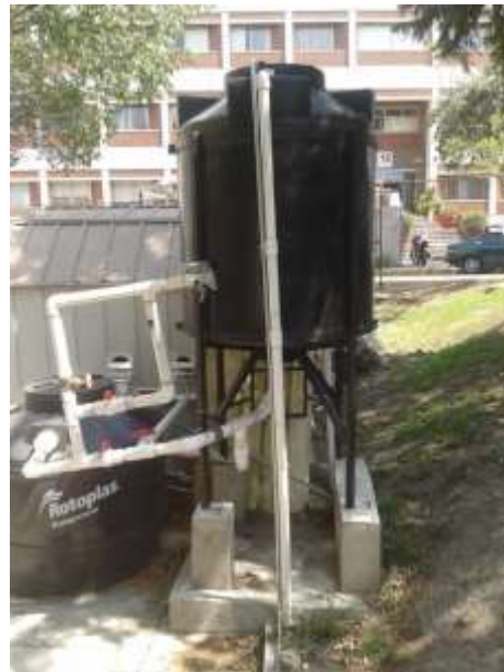
Figura 4-7. Tanque de igualación
