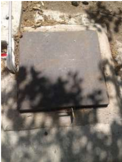
Figura 4-5. Cárcamo de bombeo
