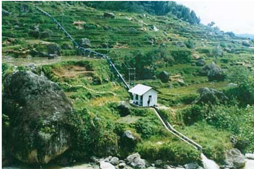
Figura I.7 Miniproyectos hidroeléctricos: Sobre la margen de una corriente y en el extremo de una tubería a presión.
