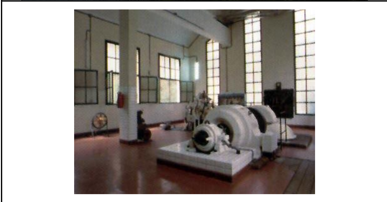
Figura I.5 Vista exterior e interior de un miniproyecto hidroeléctrico.
