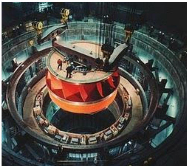
Figura I.2 Rodetes de turbinas tipo Francis.
