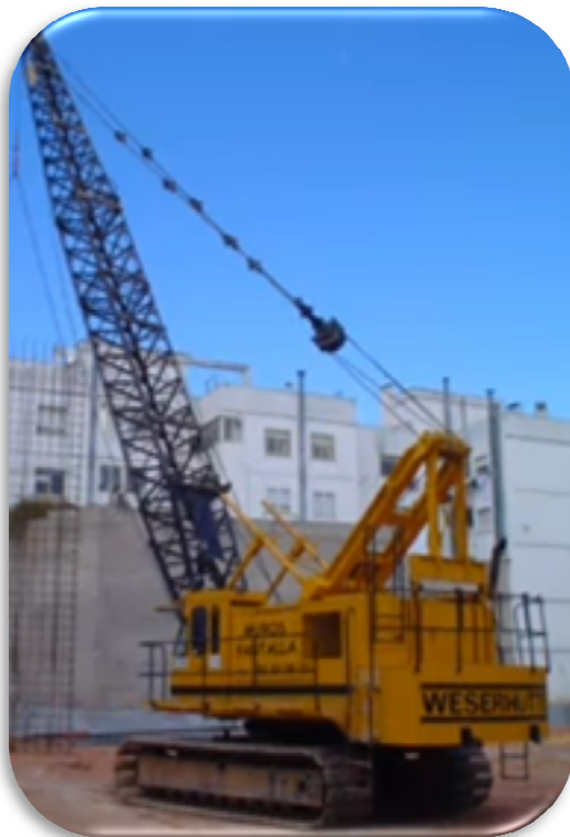
Grúa con poleas
