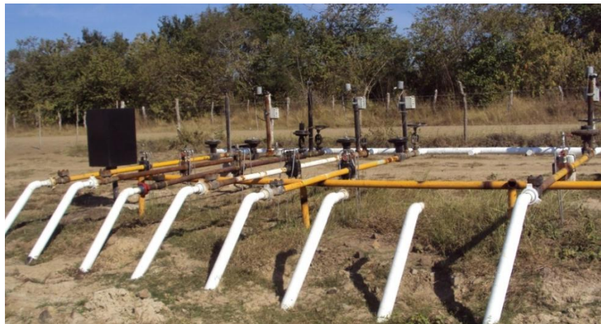
Figura 7 – Cabezal de Inyección de gas para pozos de BN
