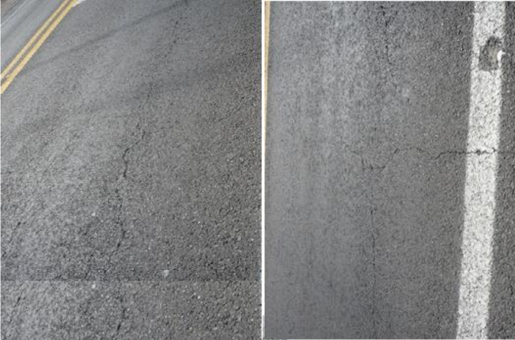
Imagen 4.14 Grietas longitudinales y transversales.
