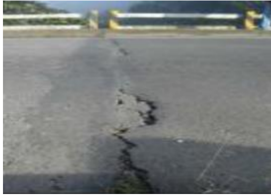
Imagen 4.18 Grietas de reflexión.
