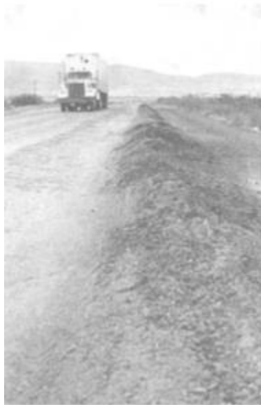
Imagen 4.13 Desplazamiento de la sección del pavimento.
