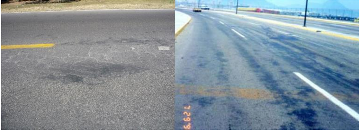
Imagen 4.5 Llorado de asfalto.
