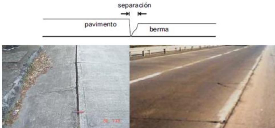
Imagen 4.39 Separación entre berma y pavimento.
