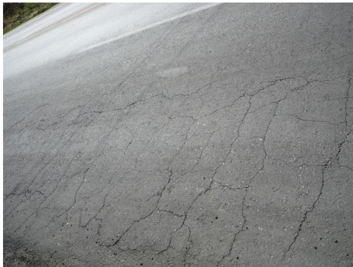
Imagen 4.16 Grietas tipo mapa.
