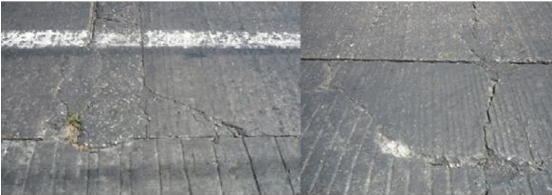
Imagen 4.25 Grietas de esquina.
