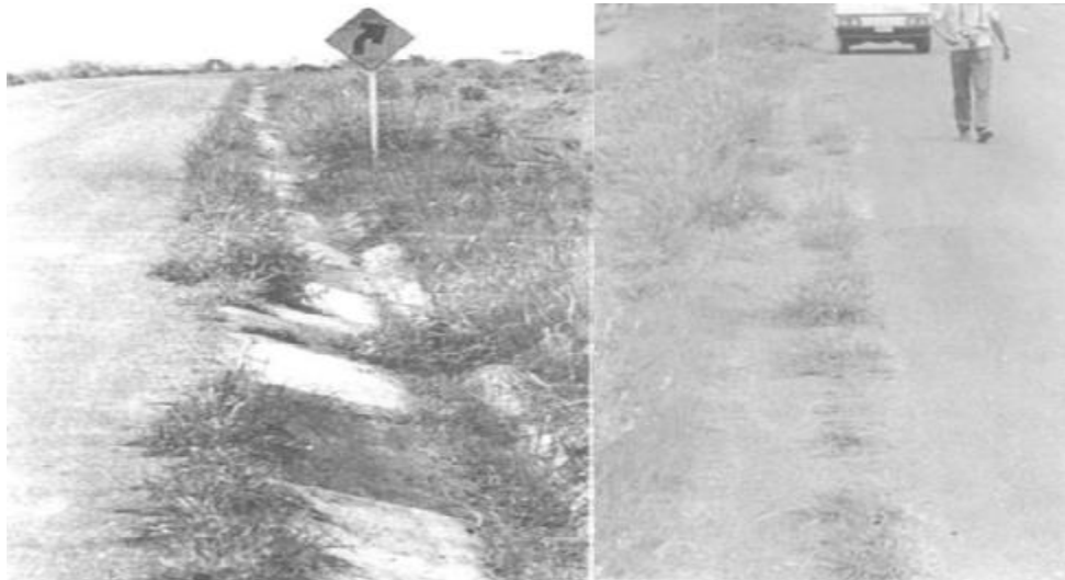
Imagen 4.40 Crecimiento de hierba en la carpeta y cunetas.
