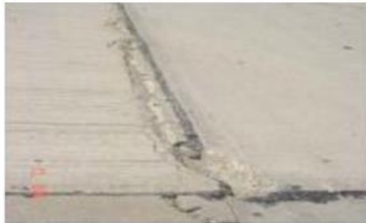
Imagen 4.23 Juntas saltadas o despostilladas.
