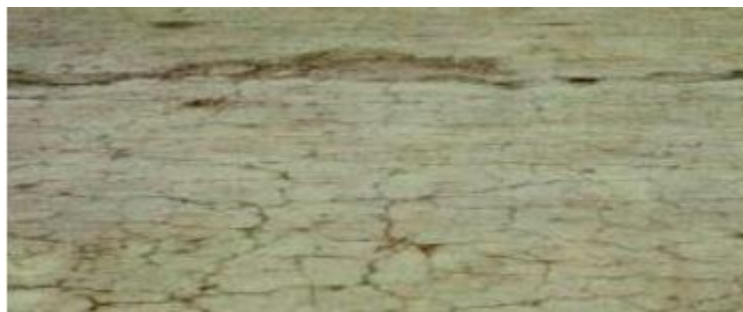
Imagen 4.28 Grietas en bloque.
