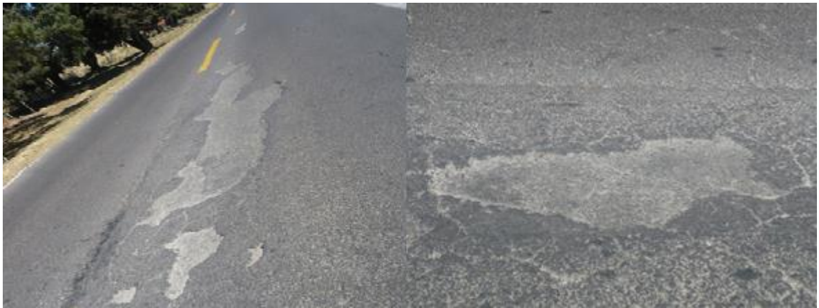
Imagen 4.4 Pérdida de capa de rodadura/Desprendimiento de sello.
