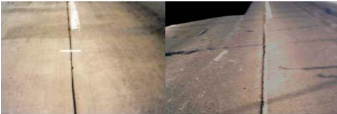
Imagen 4.24 Separación de la junta longitudinal.
