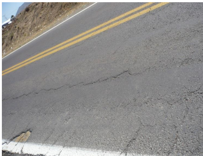
Imagen 4.12 Asentamientos transversales y longitudinales.
