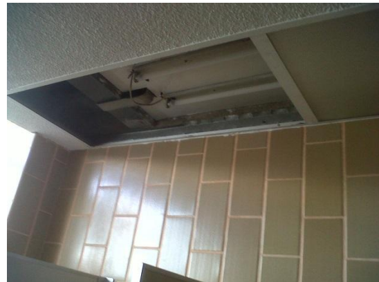
Foto 13. Falta de plafón.
