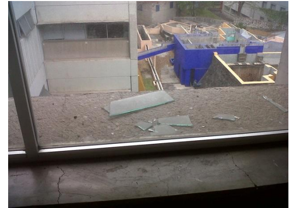
Foto 11. Riesgo de vidrios que podrían caer.
