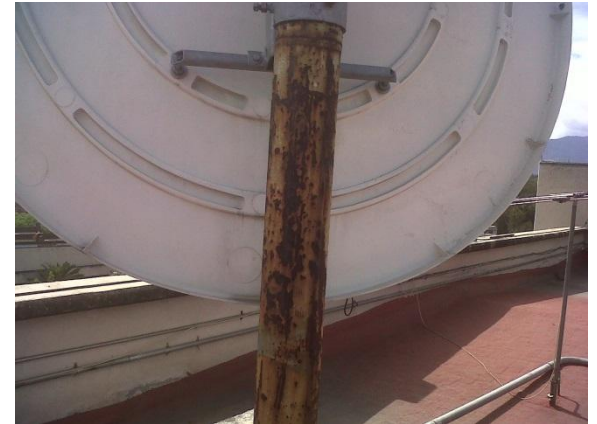
Foto 20. Oxidación de elementos.
