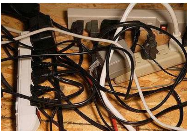
Foto 2. Instalaciones eléctricas saturadas.
