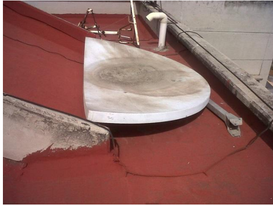
Foto 16. Caída de antena.
