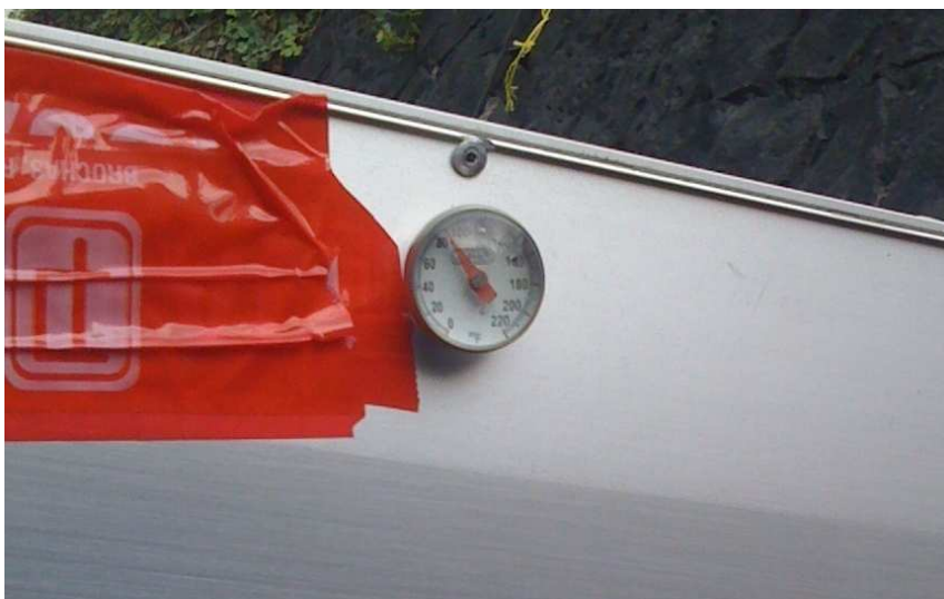
FIGURA 0.5 Termómetro del colector solar "B"
