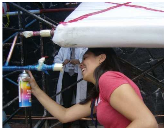
FIGURA 3.8. Identificación de tuberías de entrada
