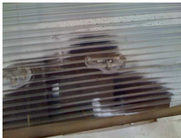
FIGURA 3.19. Deformaciones en el colector "A"
