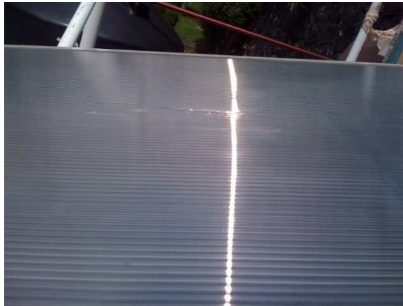
FIGURA 3.18. Deformaciones en el colector "A"
