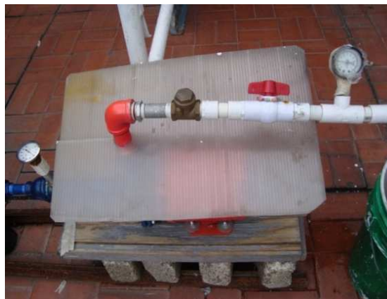
FIGURA 3.10. Termómetros y manómetros de entrada y salida
