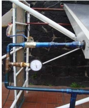
FIGURA 3.11. Termómetros y manómetros de entrada y salida
