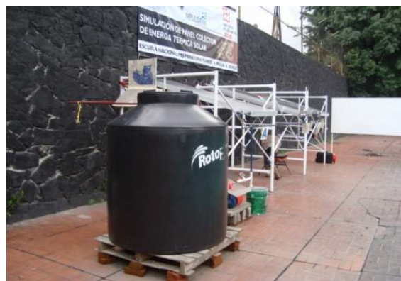
FIGURA 3.6. Tanque de almacenamiento
