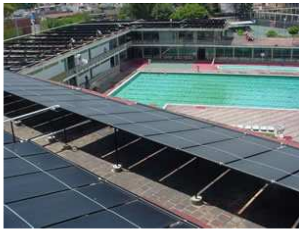
FIGURA 2.16 Colectores solares de placa plana para calentamiento de albercas.
