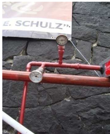
FIGURA 3.12. Termómetros y manómetros de entrada y salida
