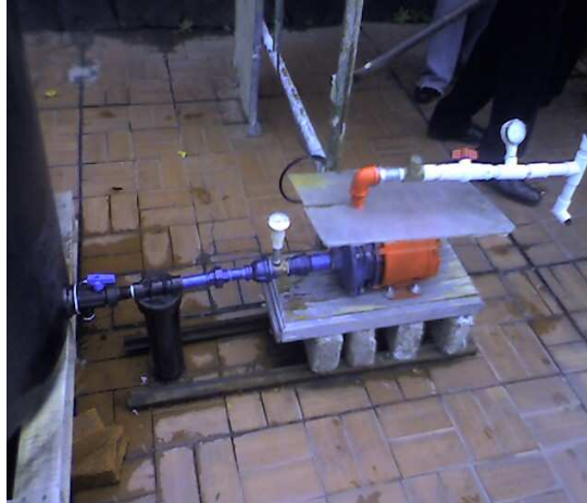
FIGURA 3.20. Goteo en el sistema de bombeo.
