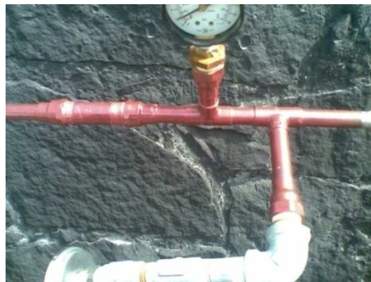
FIGURA 3.15. Colector Solar A.
