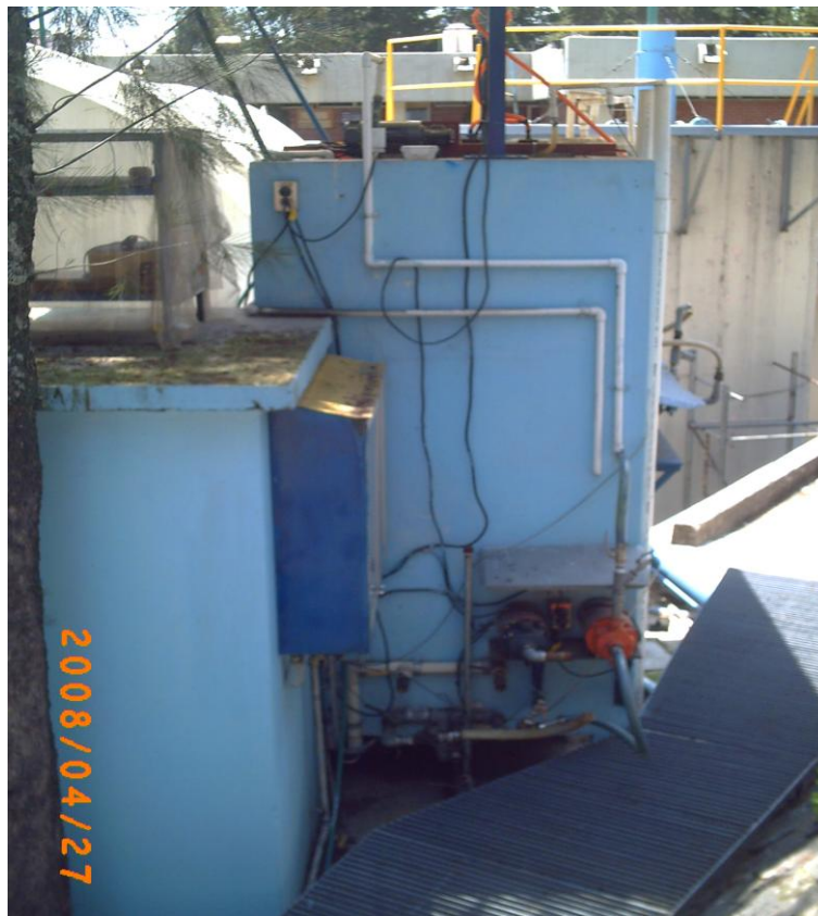
Figura 4.3. Vista lateral del reactor fermentador.
