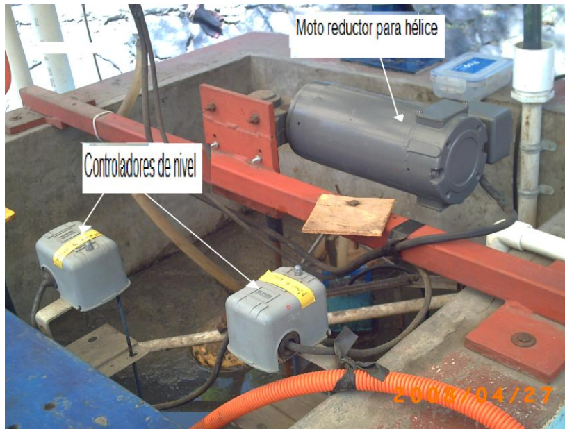
Figura 4.2. Vista de los componentes de operación del reactor fermentador.
