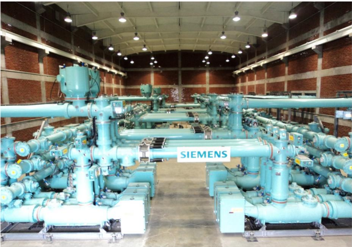
Imagen final de la subestación totalmente ensamblada.
