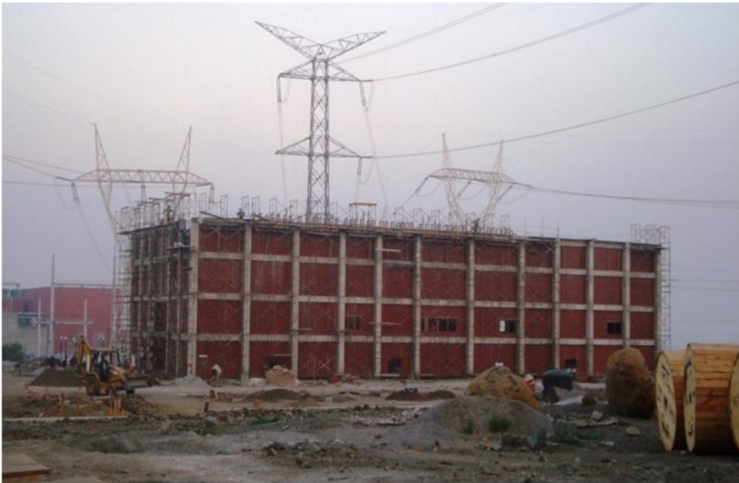
Edificio en construcción donde se instaló la subestación encapsulada en gas SF6
