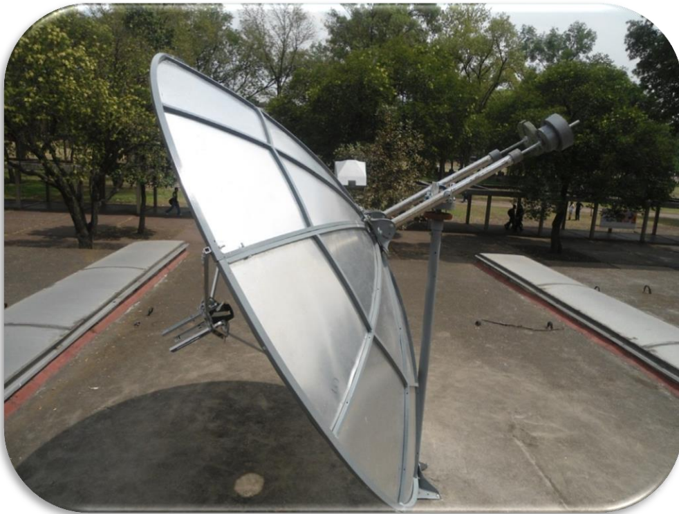
Imagen 2.20. Concentrador Solar totalmente instalado.
