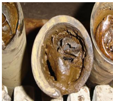
Fig. 3.2 Acumulación de incrustaciones y sedimentos que dejaron fuera de uso una tubería conductora de agua producida para re-inyección en el campo Tamaulipas-
