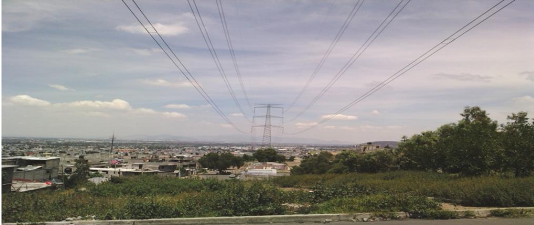
Figura 2.1 Líneas de transmisión de alta tensión.
