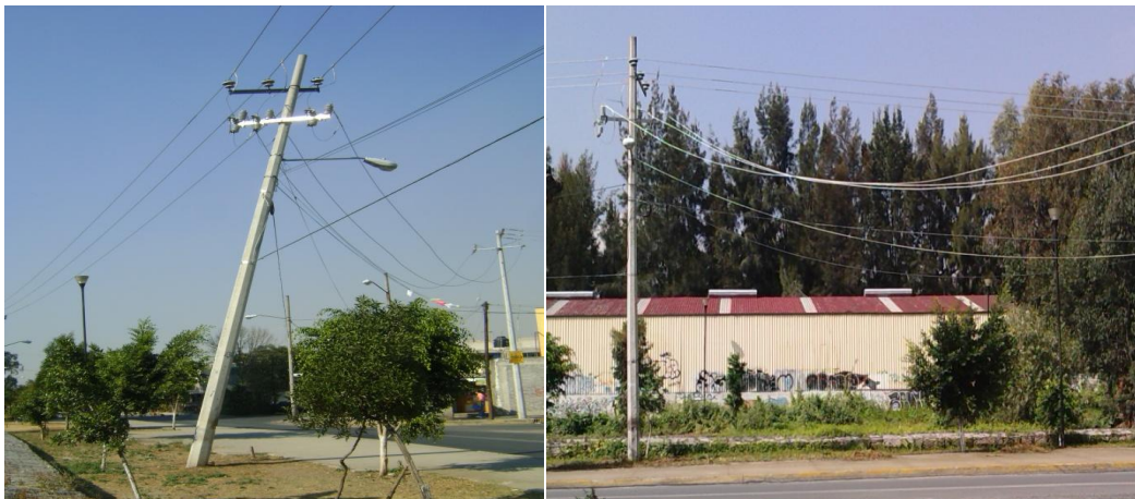
Figura 2.4 Exceso de catenaria en poste desplomado con líneas de mediana tensión.
