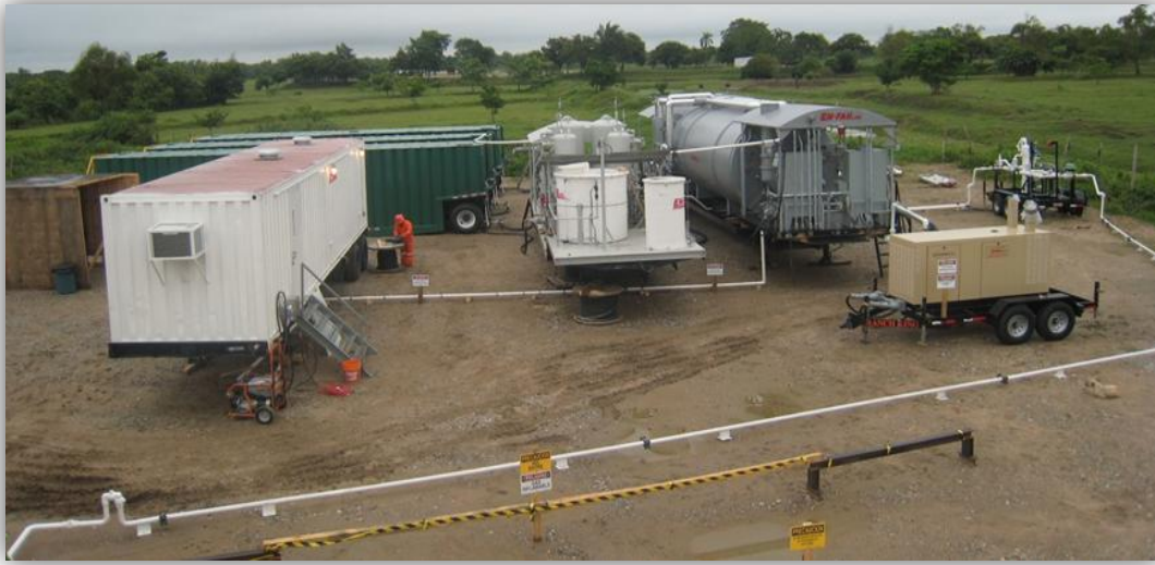
Fig. 2 Generador de vapor en campo Samaria
