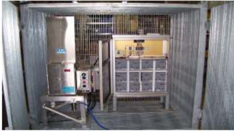
Figura 3.8 Unidad del Generador Termoeléctrico 6 .
