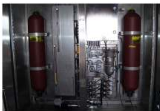
a) Sistema Hidráulico superficial y Acumuladores
