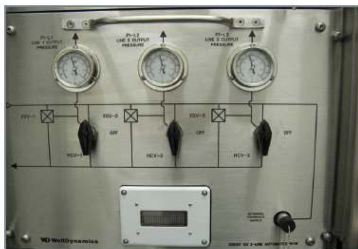
Figura 3.12 Modulo Controlador de Pozo 7 .
