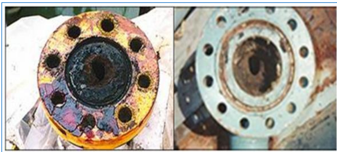
FIGURA 1.10 Obstrucción de tuberías por parafinas 17
