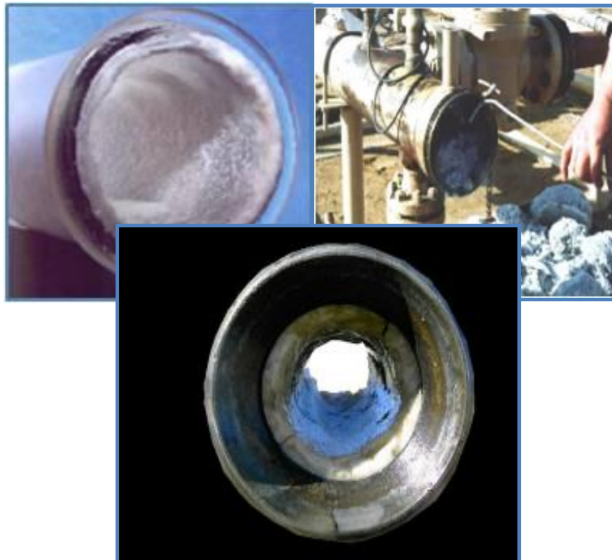
Figura 3- 12 Formación de hidratos en tuberías y equipo de tratamiento en superficie.
