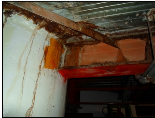
Imagen 5.1. Presencia de corrosión en elementos estructurales.
