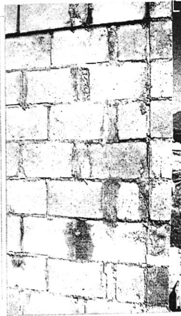
Pegado de bloque, deplomado, desalineado, y desnivelado
