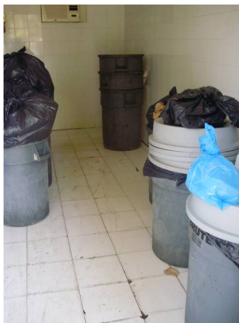
Figura 3.18 Cámara de residuos húmedos con aire acondicionado.
