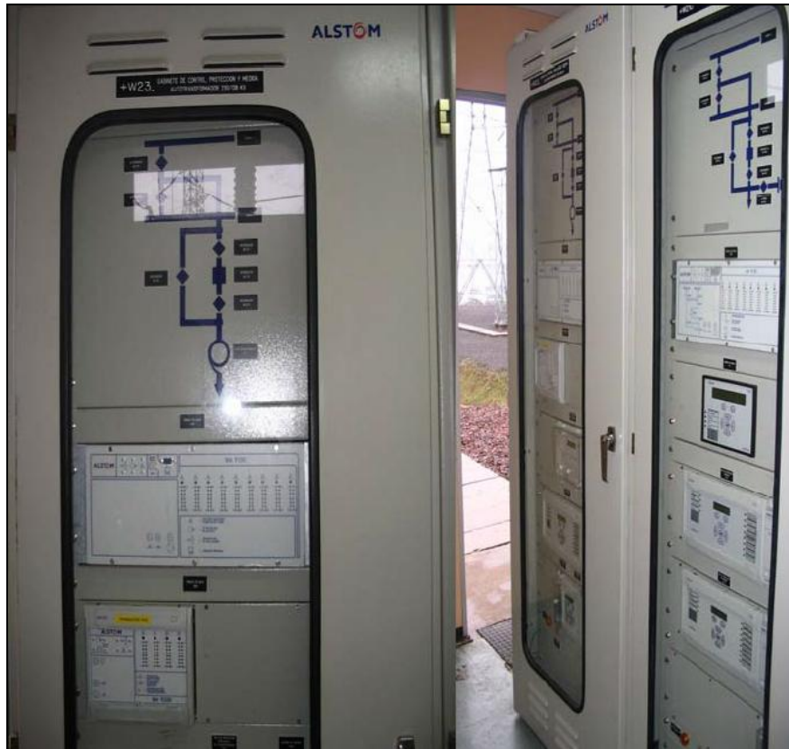
Figura 2.1.2 Tablero de Control con IDE`s
