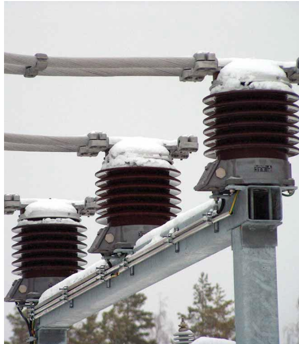
Figura 2.2. Transformadores de Corriente de media tensión abiertos [2]
