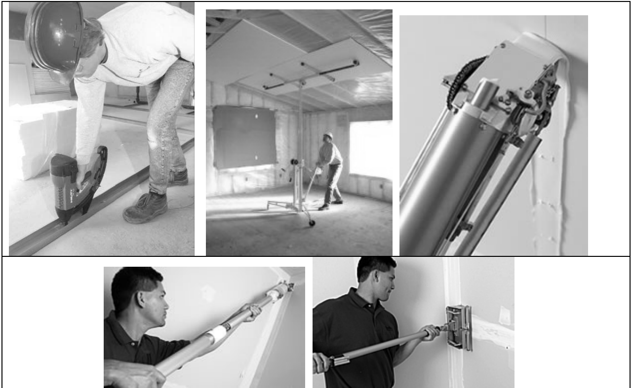
Equipos y Herramientas utilizadas en el proyecto por Beck Internacional de México en el Centro Medico ABC Santa Fe.
