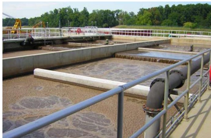
Figura 2.20 – Reactores biológicos en operación de la planta de Cauley Creek.
