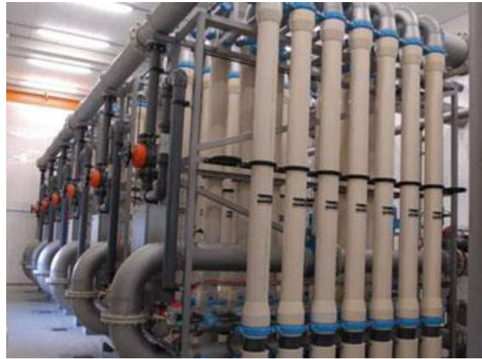
Figura 1.5 – Membranas tubulares instaladas en una planta de tratamiento. (Judd, 2013)
