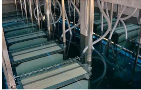
Figura 1.7 – Sistema de membranas planas instalado. (Judd, 2013)
