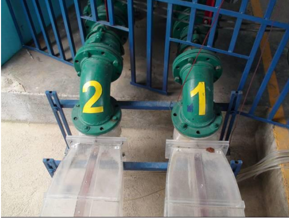
Foto 1. Tubos de aspiración y válvula de bola para simular las maniobras de toma y rechazo de carga de las turbinas
