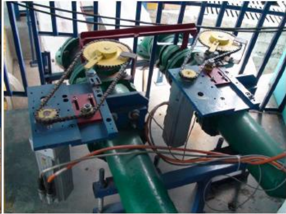
Foto 2. Servomotores para simular maniobras de toma y rechazo de carga de las turbinas
