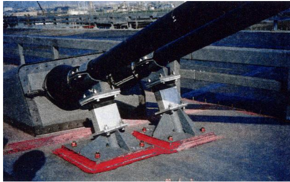
Figura 3.12 MSR instalada en un tirante
