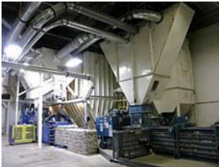
Figura 3.20 Separador neumático de residuos en una planta de selección de RSU. Fuente: http://kvaengineering.net/products/air-conveying-systems/
