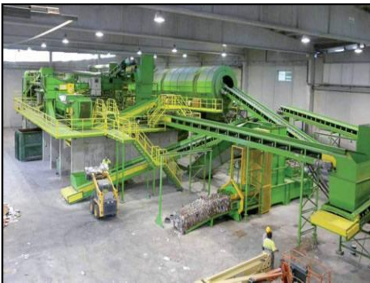
Figura 3.10 Planta de Tratamiento de RSU de Alicante, España. Fuente: http://www.retema.es/img/articulos/128_01.jpg
