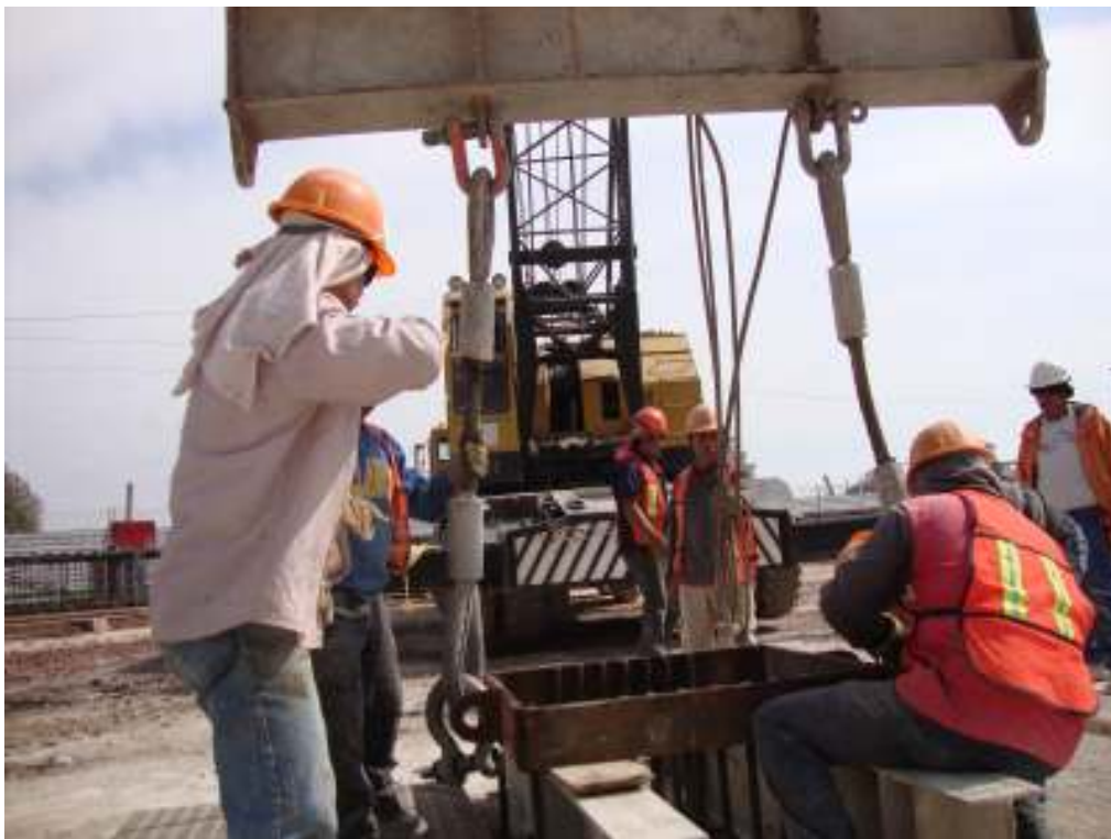
Se apoya el módulo 10 sobre vigas de apoyo temporal para iniciar el proceso de colado.
