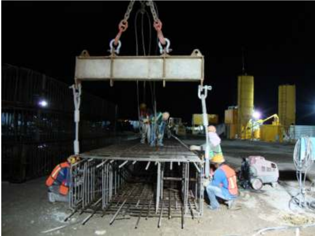
Se sujeta el módulo 1, con los dos sistemas de carga de la grúa (armado tipo A-1).
